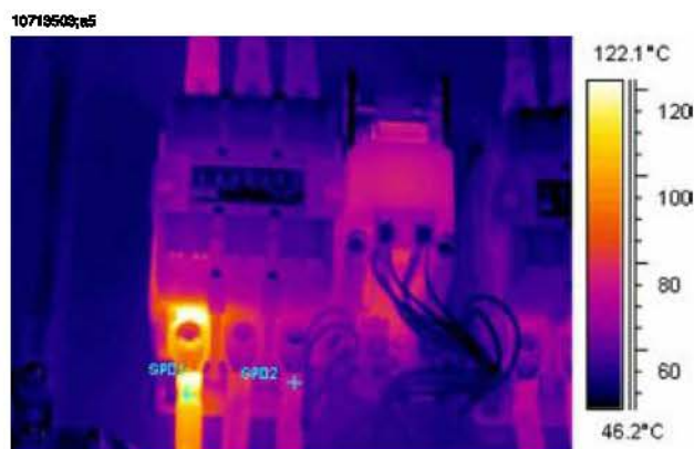
Рисунок 28.9 ИК-изображение электрооборудования внутренней установки (2).
