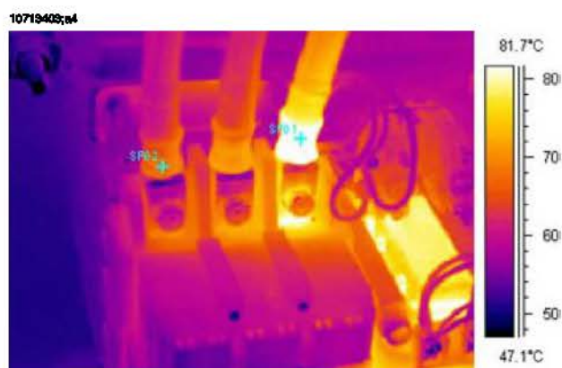
Рисунок 28.8 ИК-изображение электрооборудования внутренней установки (1).
