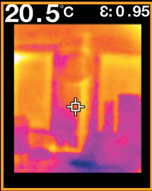
Нагретая труба в стене
