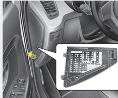
Внутренняя панель плавких предохранителей
